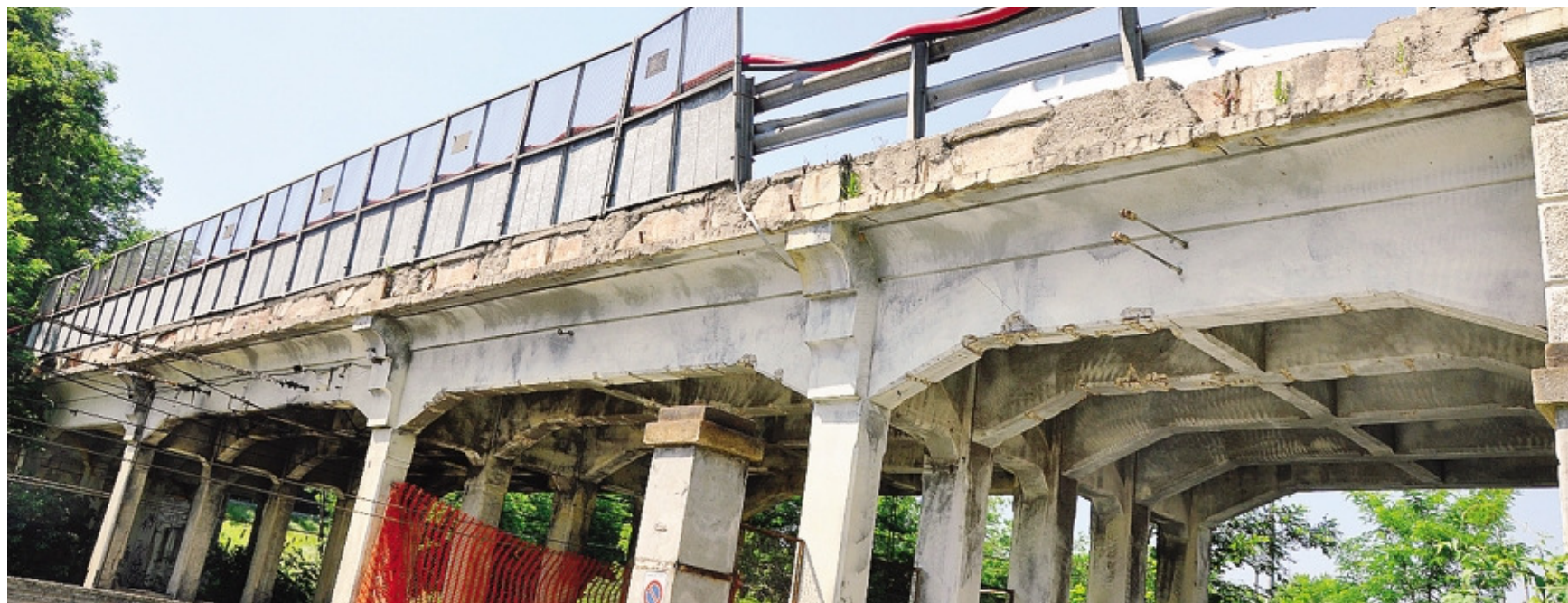
Il ponte di Cantù Asnago ha bisogno di interventi urgenti: il cantiere dovrebbe riuscire a renderlo più sicuro
