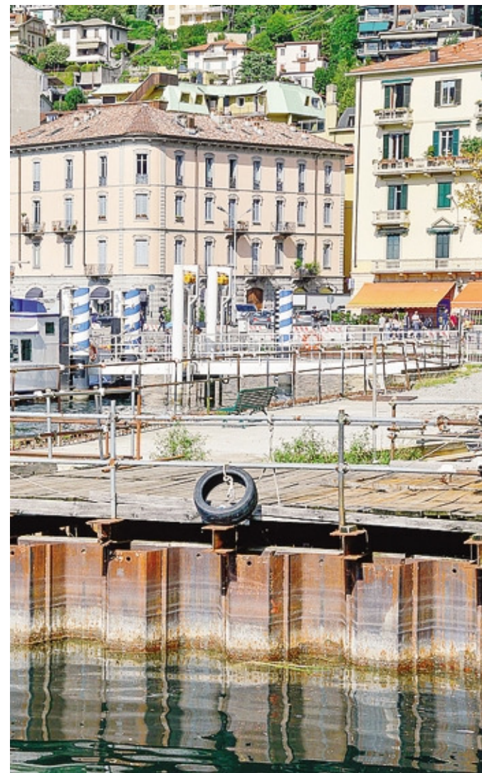
Il cantiere delle paratie è fermo dal 2012
