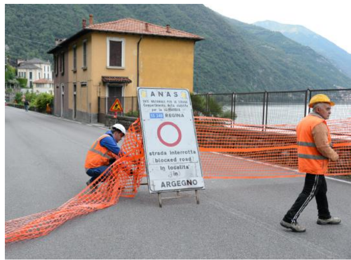
Operai dell'Anas al lavoro ieri sera per chiudere la Regina ad Argegno (foto Nassa)
