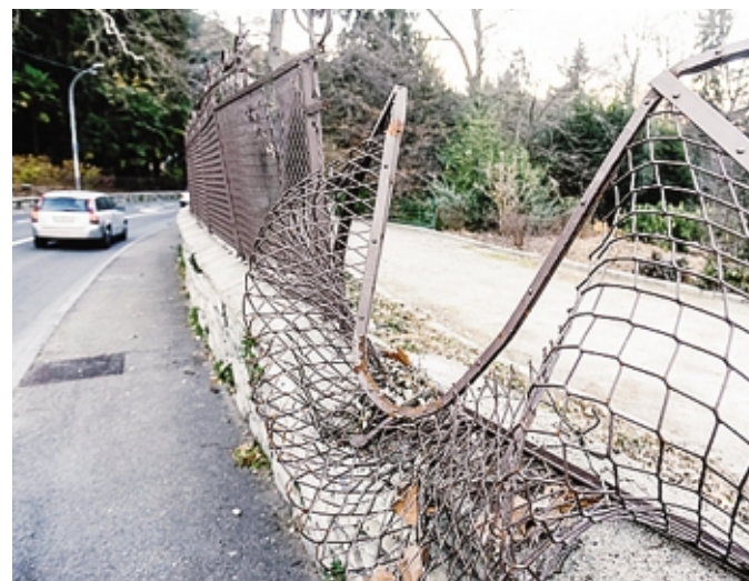
La recinzione di Villa Olmo danneggiata dall'albero caduto a dicembre
