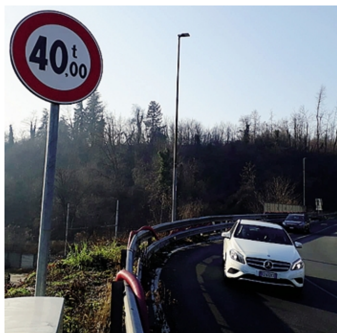
La portata è di 40 tonnellate: scatta il rosso se due tir si incrociano
