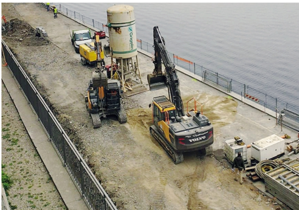
Il cantiere di Colonno della Variante dopo il maxi botto da 130 kg di esplosivo: il muro è integro
