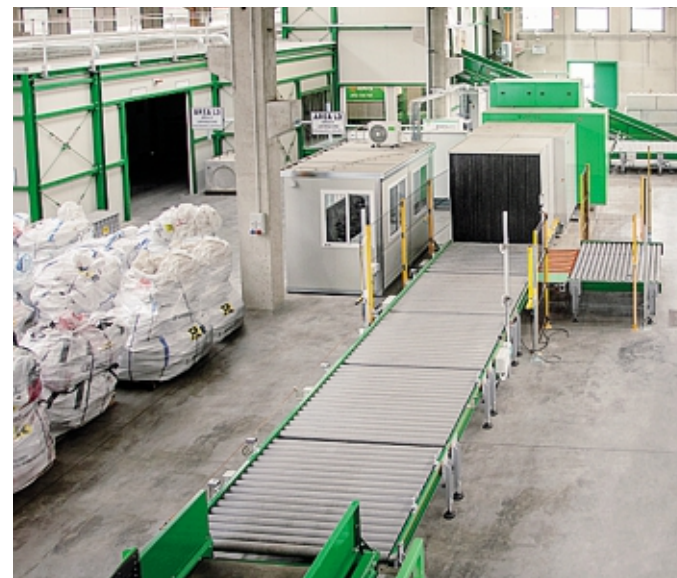
L'impianto realizzato dalla Orac'è
