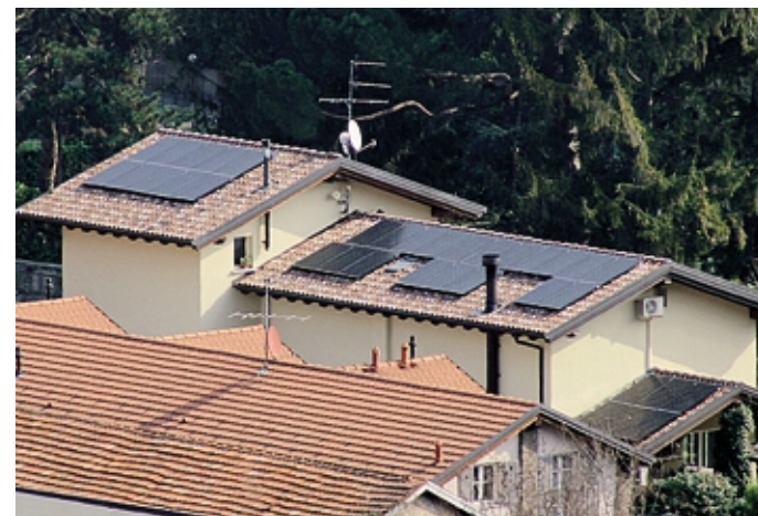
Pannelli sul tetto di alcune abitazioni
