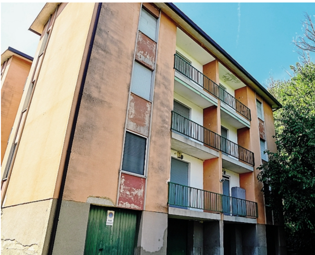
Le case popolari di via Spartaco sono un esempio di patrimonio immobiliare da riqualificare
