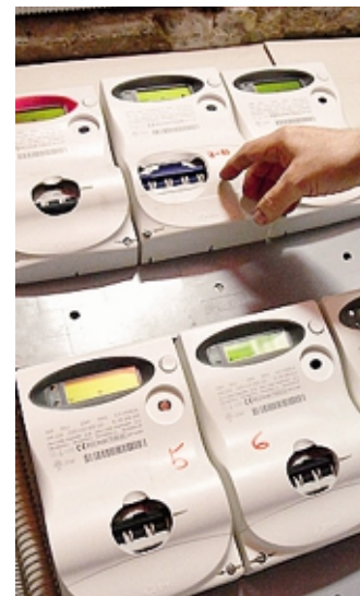
Contatori dell'energia elettrica
