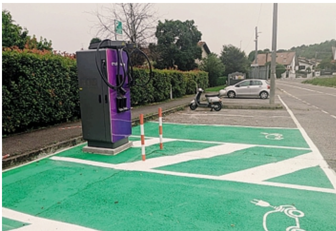
L'installazione delle colonnine non è agevolata dai bonus fiscali
